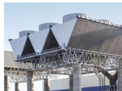
ACC di nuova generazione a tiraggio indotto
